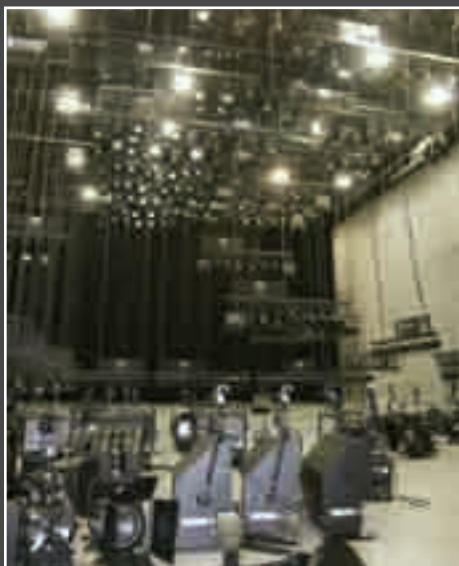
Hệ thống ánh sáng trường quay S14
